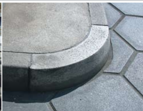
Fugenabdichtung im Wirkbereich
