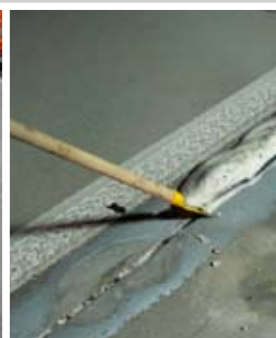
Entfernen des durch Aufschäumen ausgetretenen PU-Harzes
