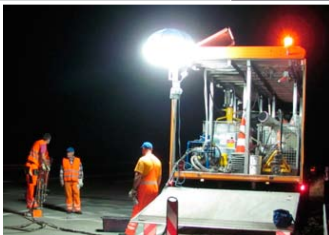
Die Ausführung in Nacharbeit ermöglicht eine Verkehrsfreigabe am frühen Morgen vor der Rush Hour
